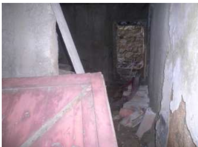
Vandalismo in una casa abbandonata
